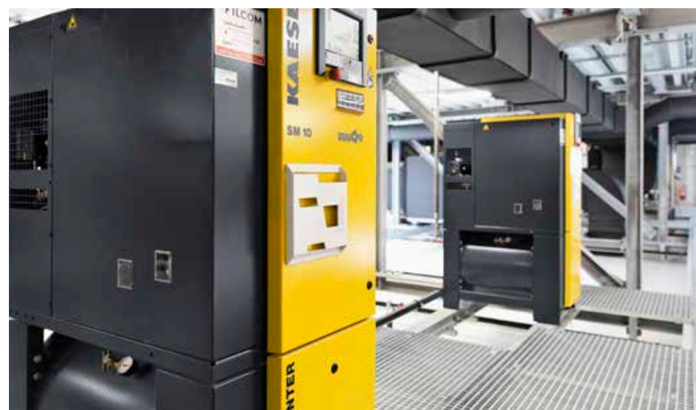
V novém logistickém centru se využívají dvě zařízení AIRCENTER.
